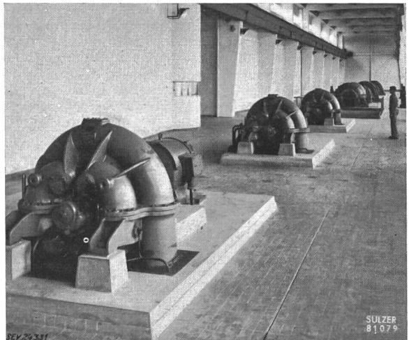
Fig. 2 Maschinenhalle einer grossen Leuchtgasverteilzentrale in Paris. Diese modernste Anlage Europas ist mit drei Sulzer- Radialverdichtern (Vordergrund) und zwei Sulzer- Axialverdichtern (Hintergrund) ausgerüstet
