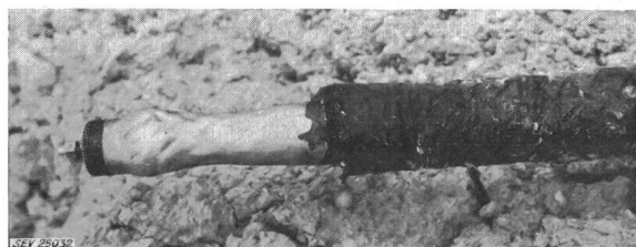
Fig. 12 Tête de câble déformée par suite d'un tirage à l'aide d'un filet
