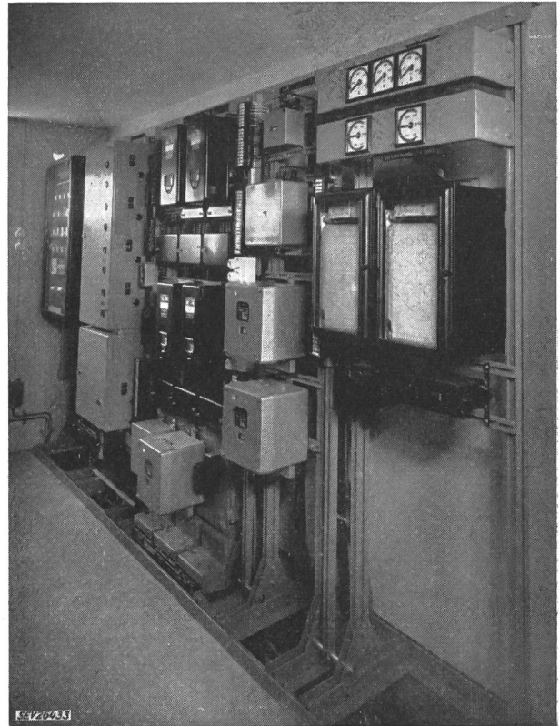
Fig. 9 Relaisstation der Freiluftanlage «Kaisterfeld»
