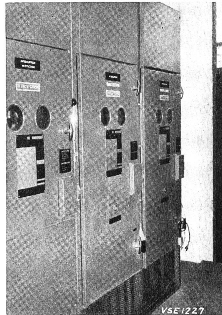
Fig. 7 Vue de face d'une armoire de couplage
