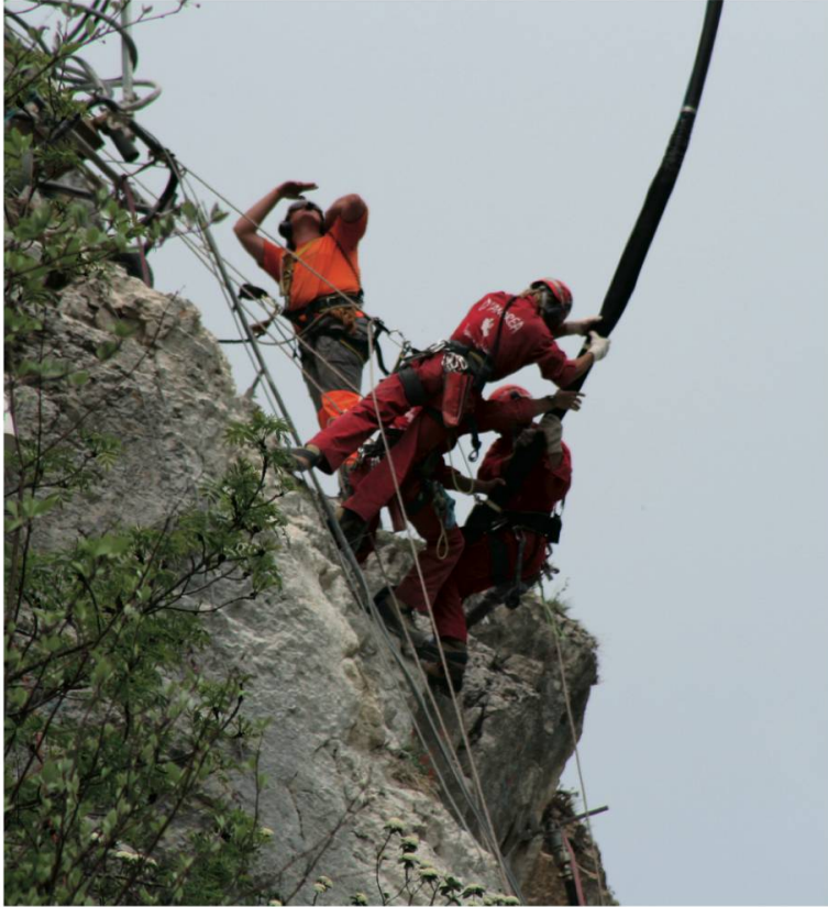
Figure 9: «jumeau», mise en place des tirants d'ancrage en falaise à trente mètres au-dessus de la H18, à l'aide de l'hélicoptère.
