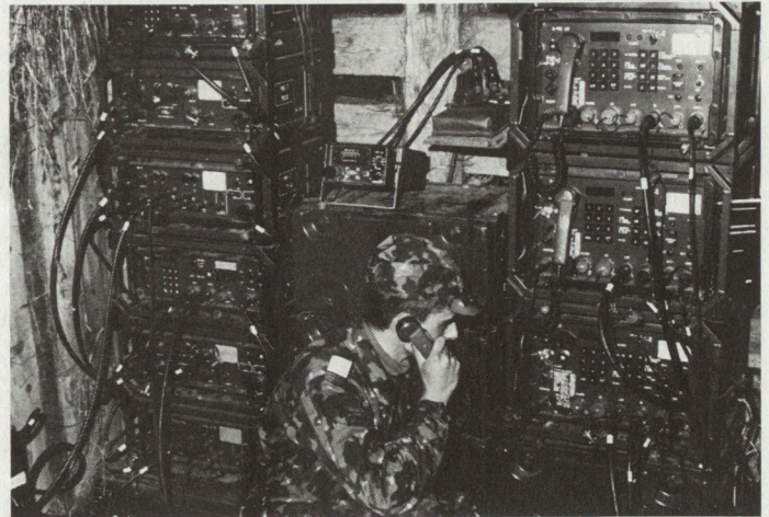
Bild 6. Richtstrahlübertragung im IMFS-90: Mehrere Telefonleitungen werden in der Mehrkanalausrüstung MK-7 (links oben) gesammelt, im Chiffrierzusatz CZ-1 (links unten) verschlüsselt und über die Bedieneinheiten an die Antenne(n) der Richtstrahlstation R-915 weitergeleitet. Hersteller MK-7: Hasler AG, Bern; CZ-1: BBC, Baden.
