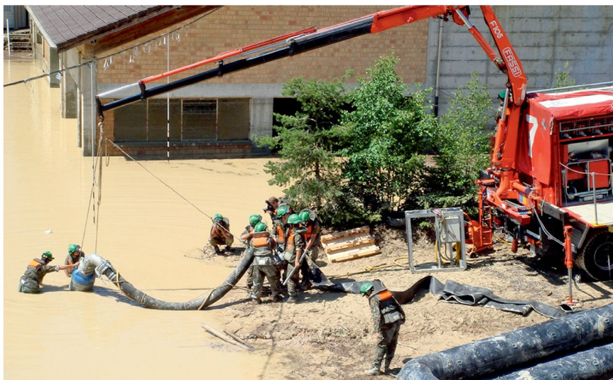
Einsatz des WELAB 7 (Überschwemmung) in Rapperswil BE (Juni 2006).
