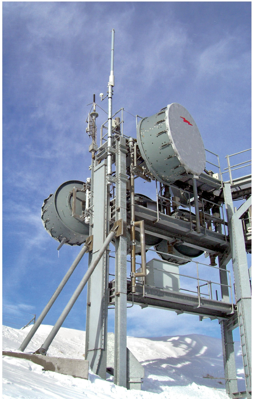
Link 16 Antenne auf einem Höhenstandort.
