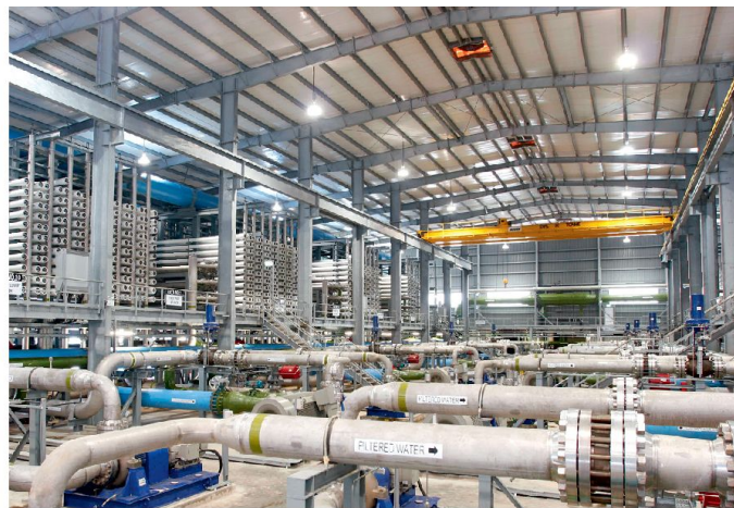
Meerwasserentsalzungsanlage in Saudi-Arabien. Bild: arabianbusiness
