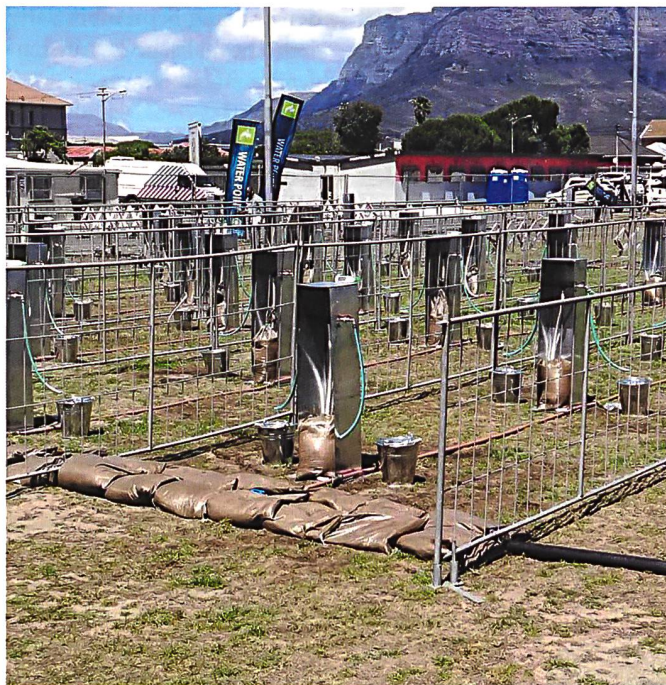
Wasserabgabestelle in Kapstadt.
