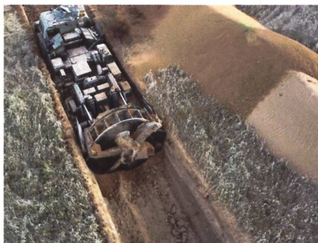
In der Nähe der Kleinstadt Hirske erstellen Wagner-Truppen einen mehrstufigen Verteidigungswall. Zum Bau der tiefen Gräben kommt auch eine Pioniermaschine vom Typ MDK-3 aus der Sowjet-Ära zum Einsatz. Bild: Screenshot Rifaan
