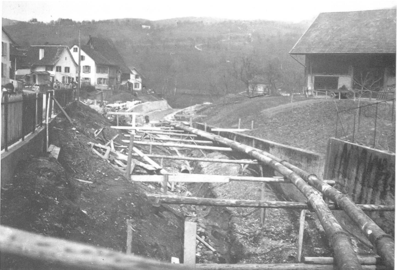
Im Bereich unterhalb der «Schlifibrücke» ist die Bachverbauung in vollem Gange. Im Hintergrund die noch unüberbaute Sonnhalde.
