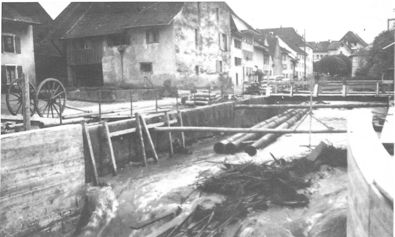
Hochwasser während der Arbeit an der Bachverbauung (2. Juli 1932).
