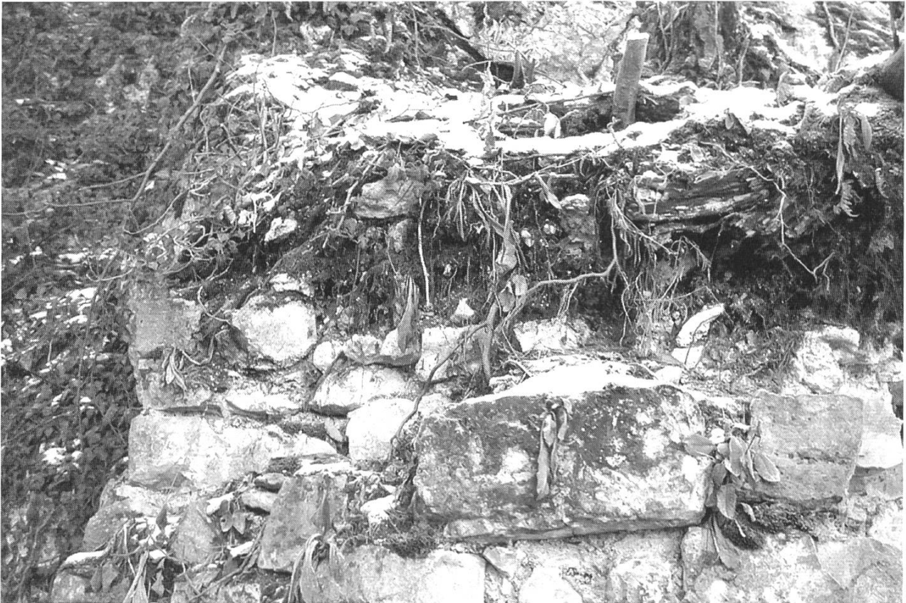
Abb. 3: Ettingen, Burg Fürstenstein. Schäden im Bereich des Einganges. Das Wurzelwerk hat die Mauerkrone vollkommen zerstört, so dass Wasser in den Mauerkerndringt.
