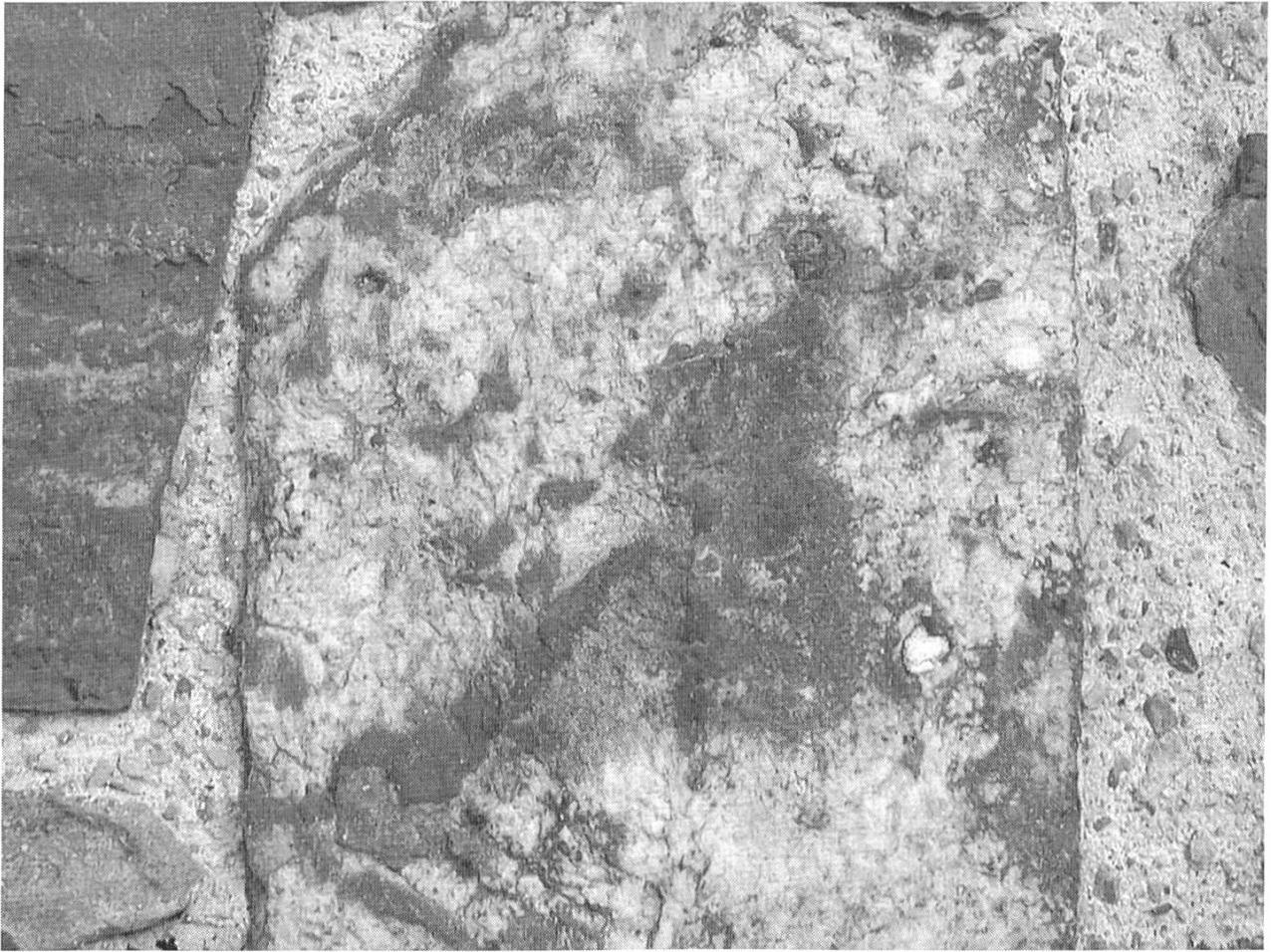
Abbildung 4: Salzausblühungen auf einem Ziegel, der bei einer früheren Mauersanierung eingesetzt worden war.
