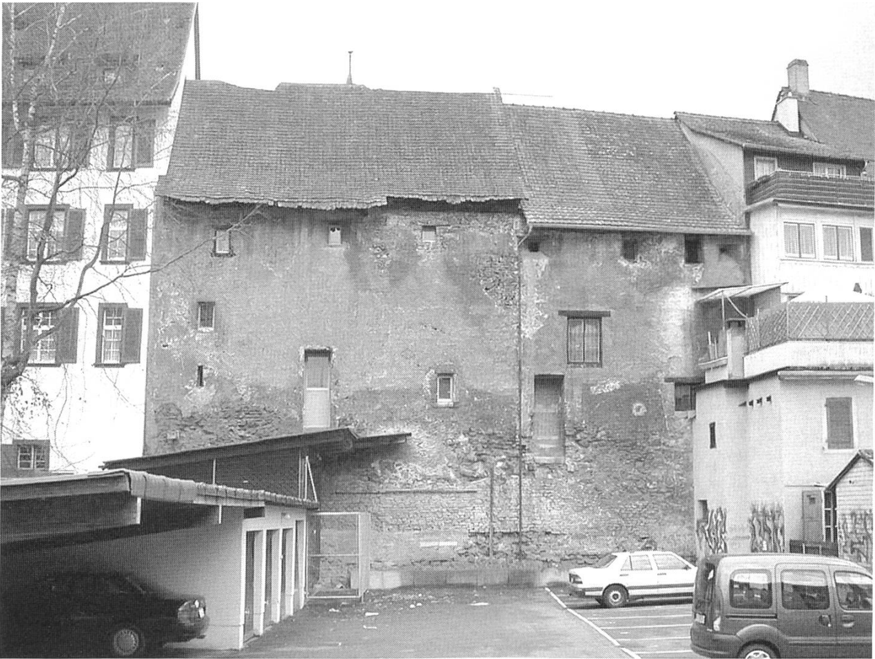
Abbildung 3: Zustand des Stadtmauerabschnitts vor Beginn der Sanierung.
