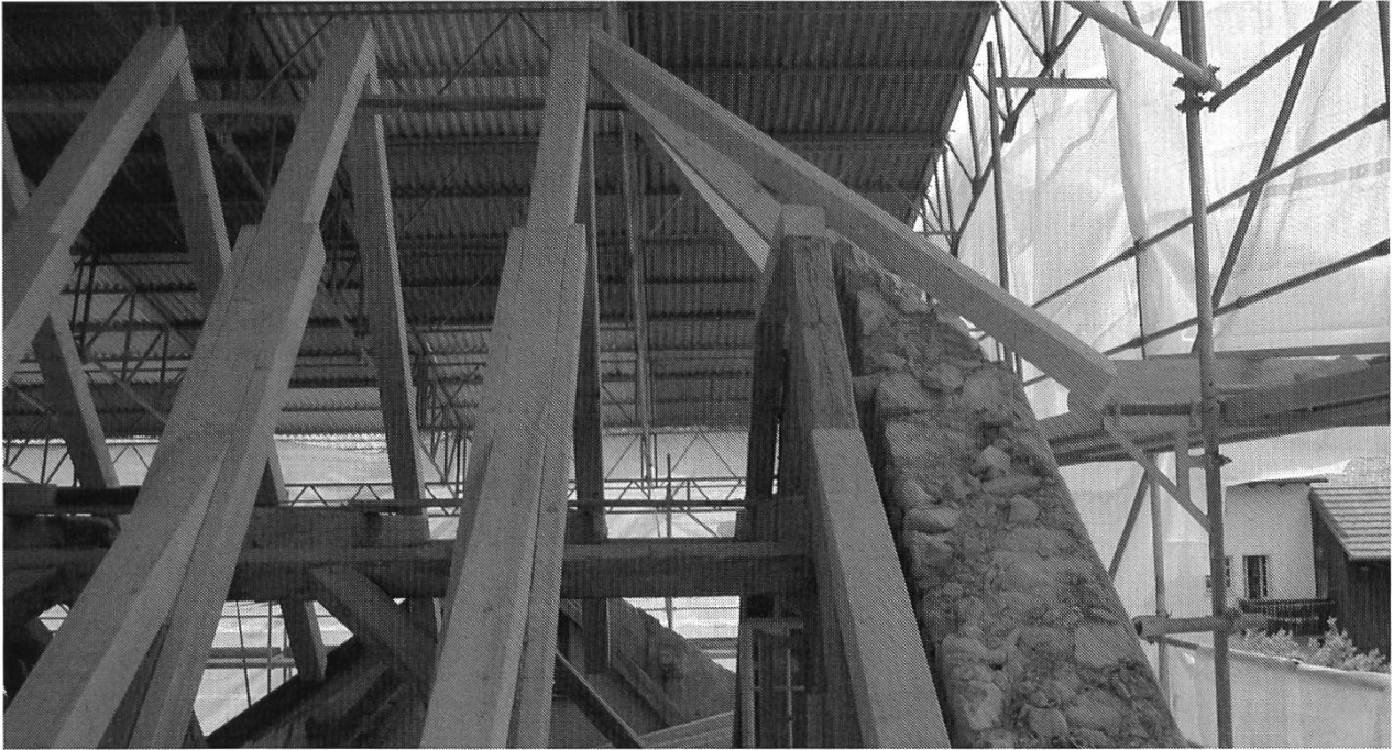
Abb. 22: Alter Dachstuhl mit angelaschten und ersetzten Sparren und Aufschieblingen.
