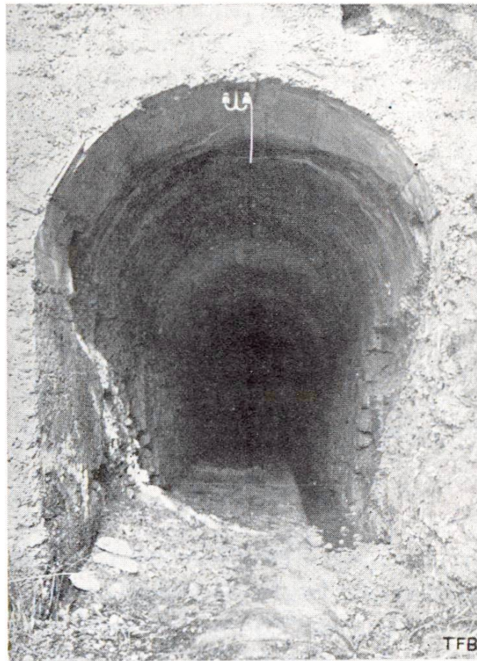
Fig. 3. Entrée d'une galerie bétonnée, vieille de 40 ans.
