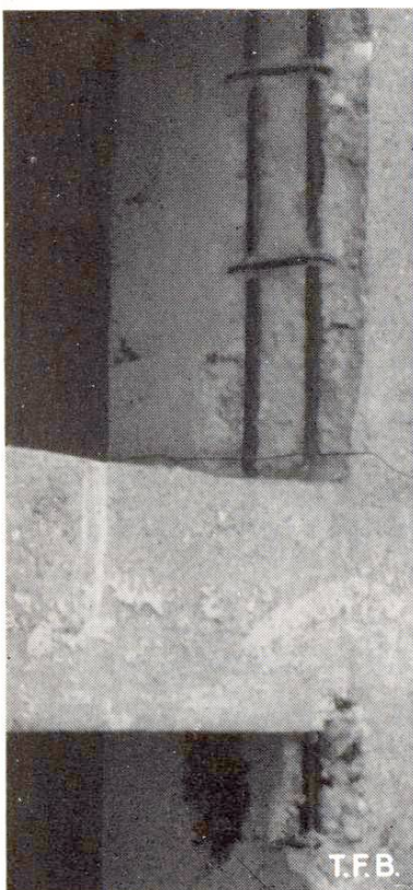
Fig. 2 Malgré une épaisseur suffisante de béton paraissant compact, les fers se sont rouillés et l'ont fait éclater. Un examen plus approfondi a montré que ce béton était perméable
