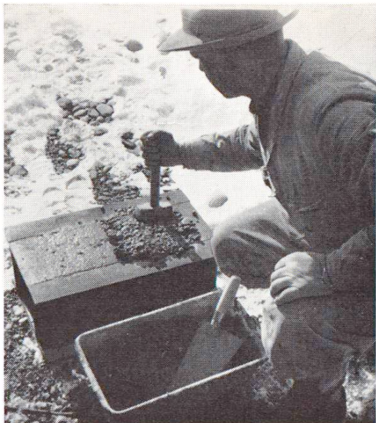
Fig. 5 Damage à la massette
