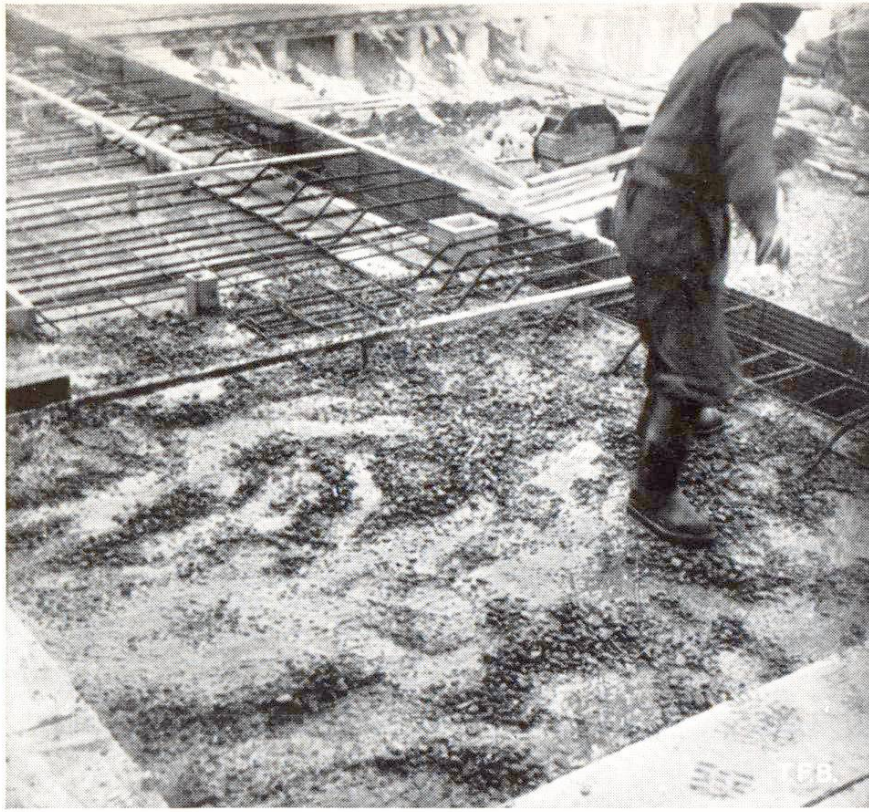
Fig. 5 Forte ségrégation dans un béton li- quide.
