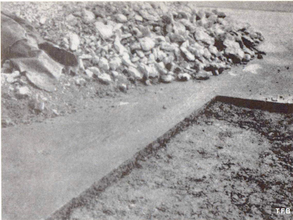
Fig. 4 Réparation d'un sol en béton. Repiquage arrêté par des faces perpendiculaires à la surface du revêtement et formant des arêtes vives
