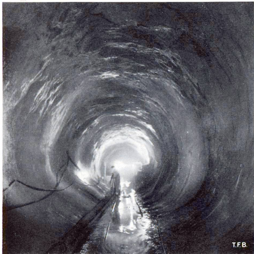
Fig. 5 Revêtement en béton projeté dans la galerie en charge Grande Dixence - Fionnay. Longueur 3,3 km. Pression maximum 22 atm.
