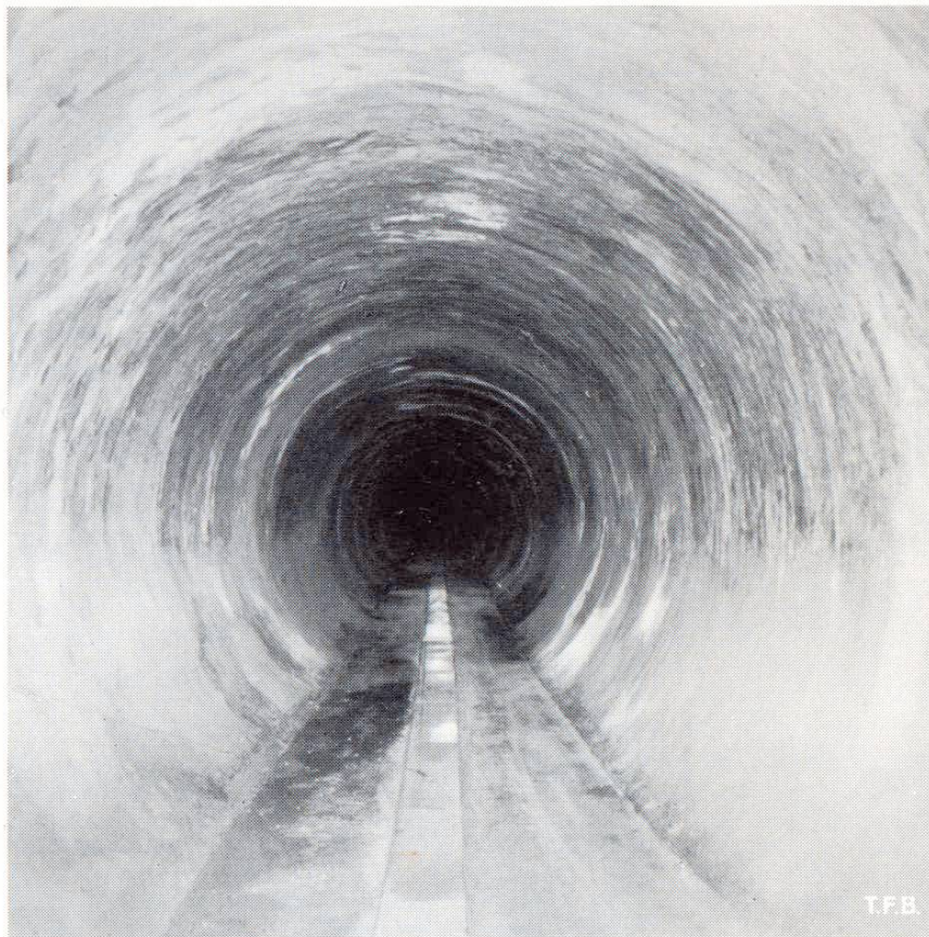
Fig. 6 Revêtement en béton projeté « tiré » au profil exact dans une galerie en charge de l'entreprise de la Maggia. (Photo F. M. M.)
