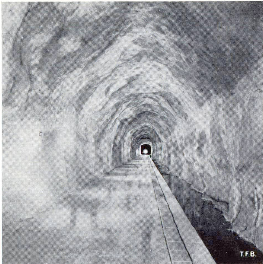
Fig. 4 Galerie à écoulement libre avec revêtement en béton projeté de l'entreprise de la Maggia. (Photo F. M. M.)
