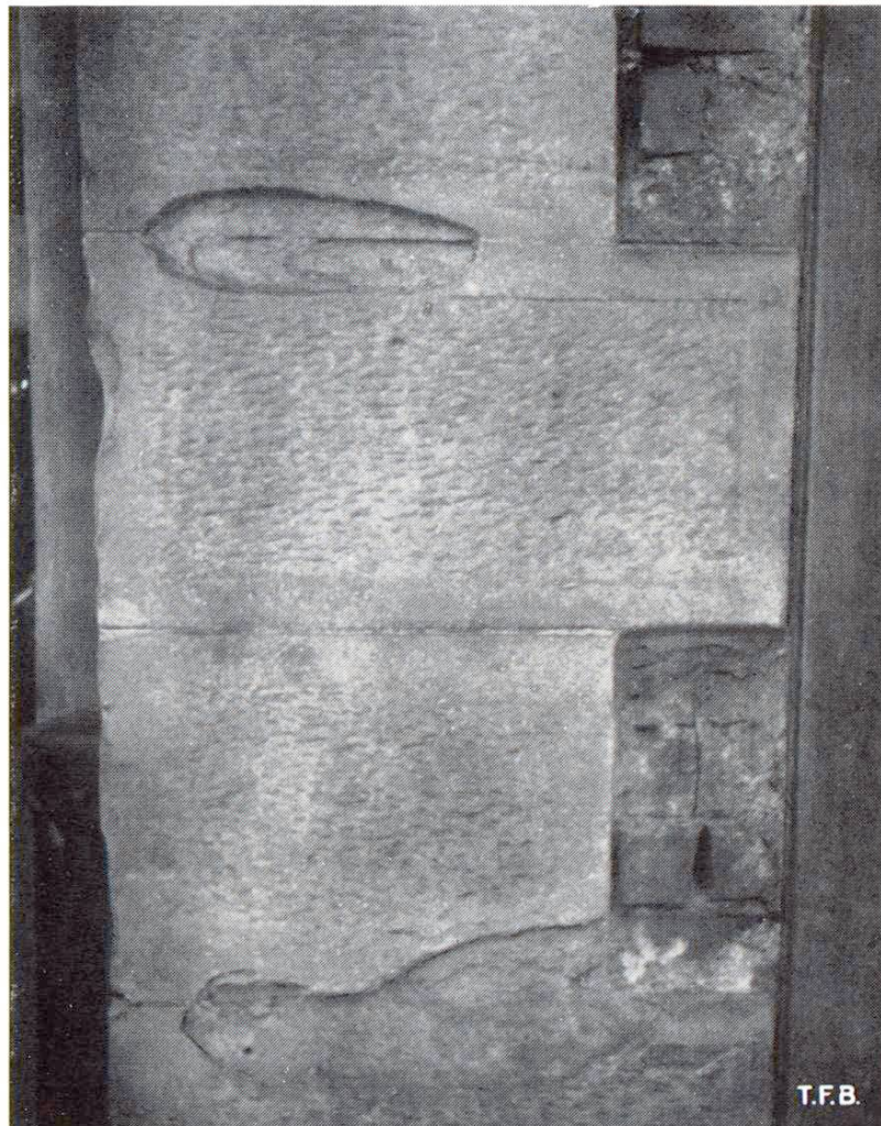
Fig. 2 Les intempéries ont provoqué ces dégâts dans une vieille construction. Le grès naturel a sauté au gel le long des joints dans lesquels l'eau a pu pénétrer. La maçonnerie de briques placée entre les blocs de pierre de taille était recouverte d'un crépi qui s'est détaché depuis longtemps. Etant en contact avec trois matériaux de comportements trop différents, il s'est d'abord fissuré puis décollé
