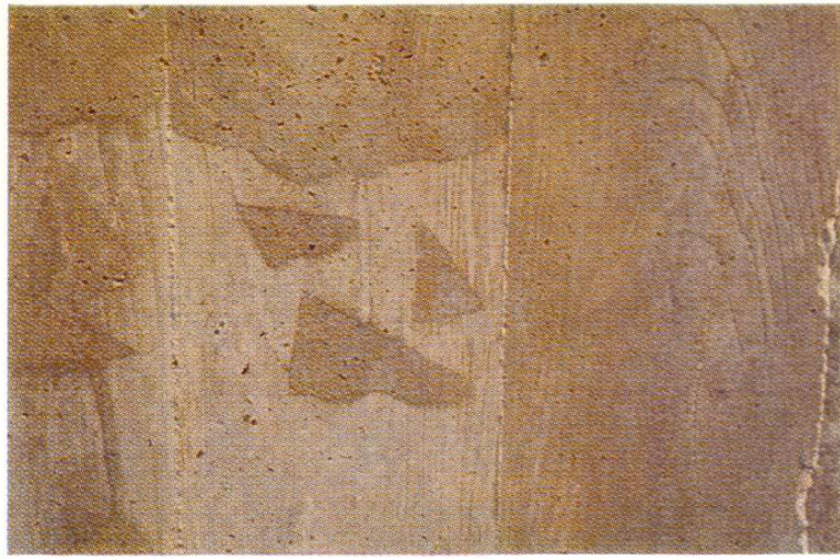
4 Fig. 3 Détail des parties altérées de la surface du béton.
