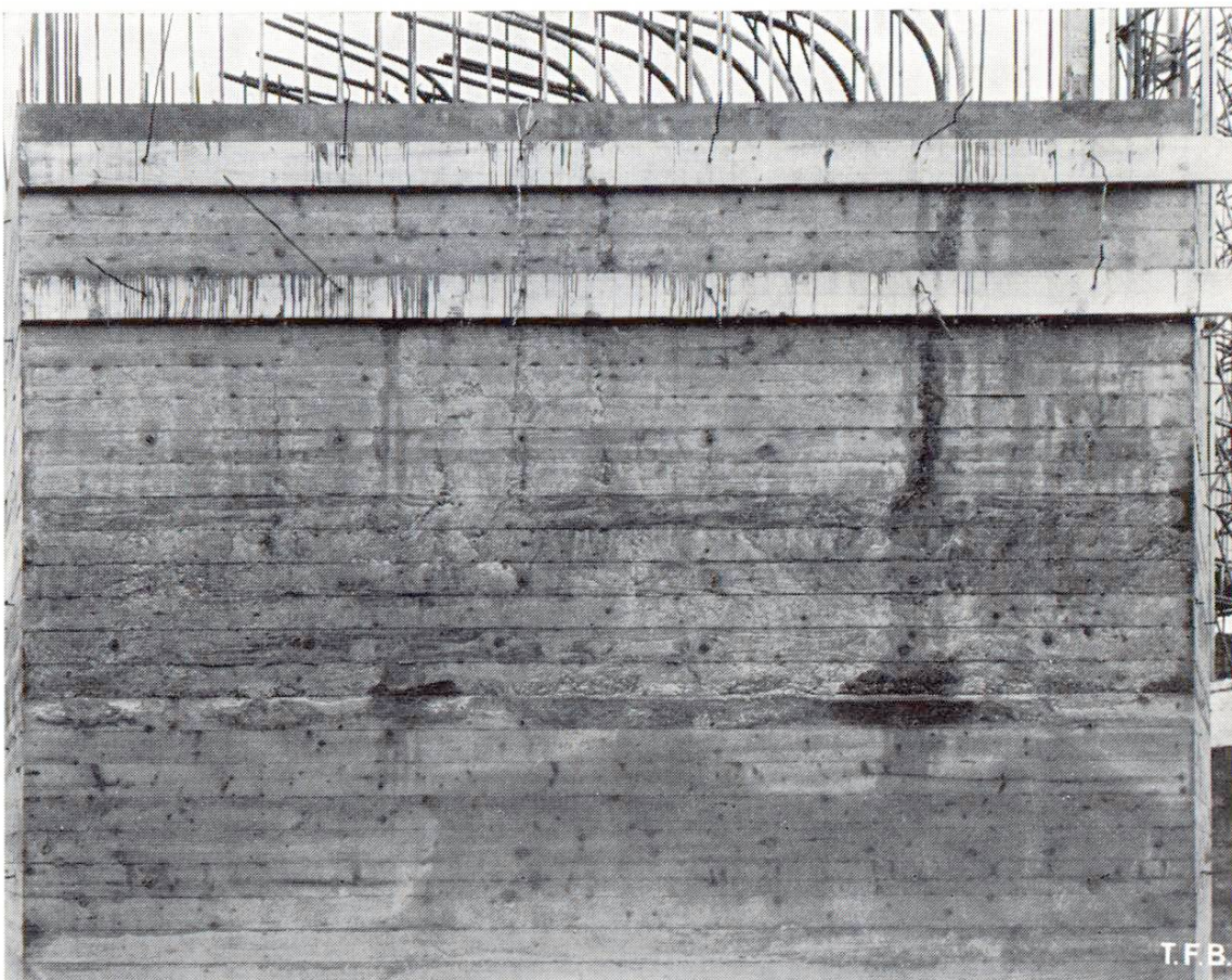
Fig. 2 Une paroi de béton apparent construite en béton coulé. Dans la moitié inférieure un joint de reprise du type 3 avec couche supérieure mal serrée. Au milieu de la hauteur, un joint type 1 avec traces bien visibles de ségrégation de l'eau (traînées verticales avec diverses teintes de gris). Surfaces presque noires dues à la pénétration d'eau de pluie dans un béton très poreux.
