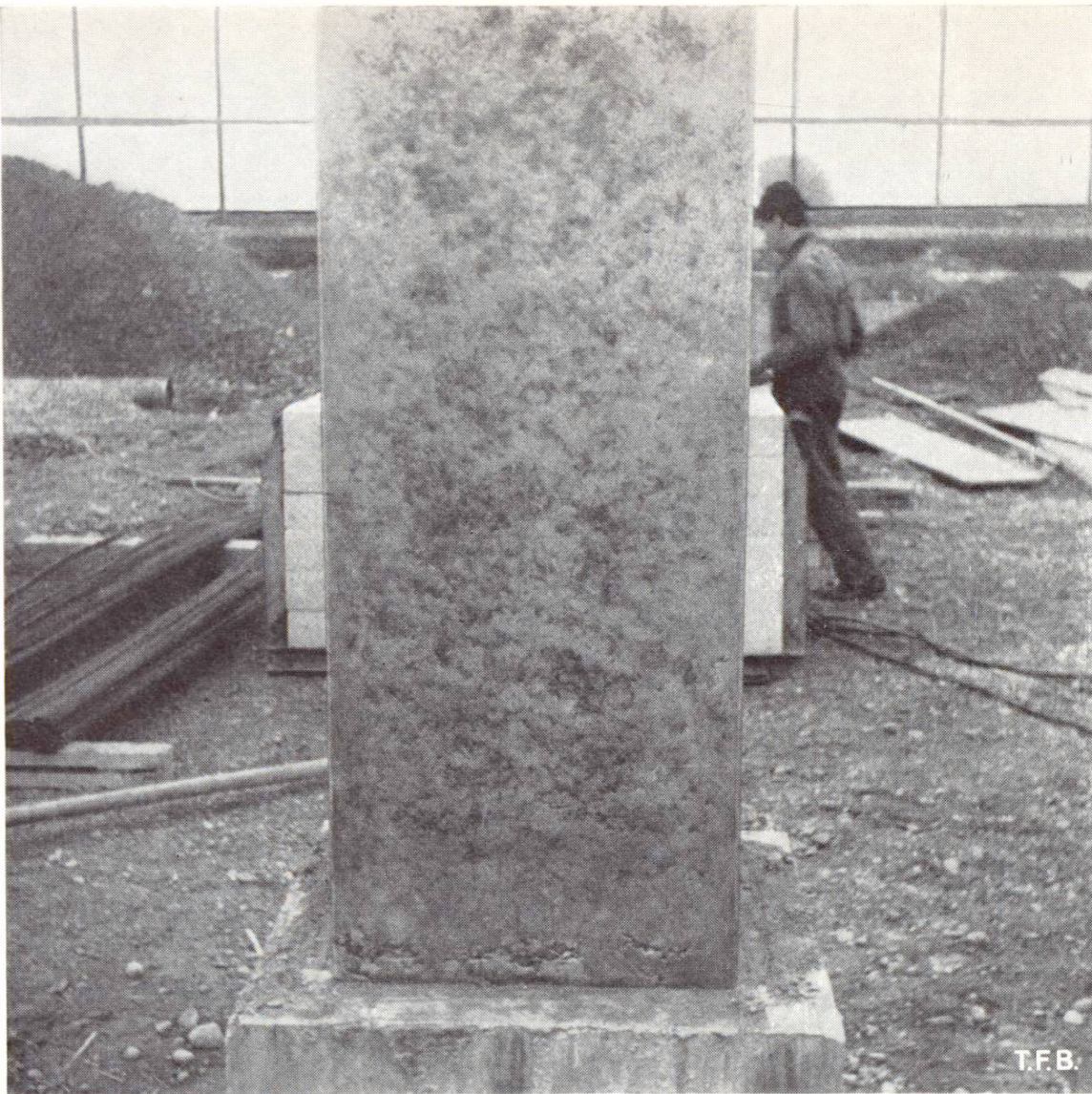
Fig. 5 Traces laissées par de faibles pertes de lait de ciment et par le tassement du béton le long du coffrage.
