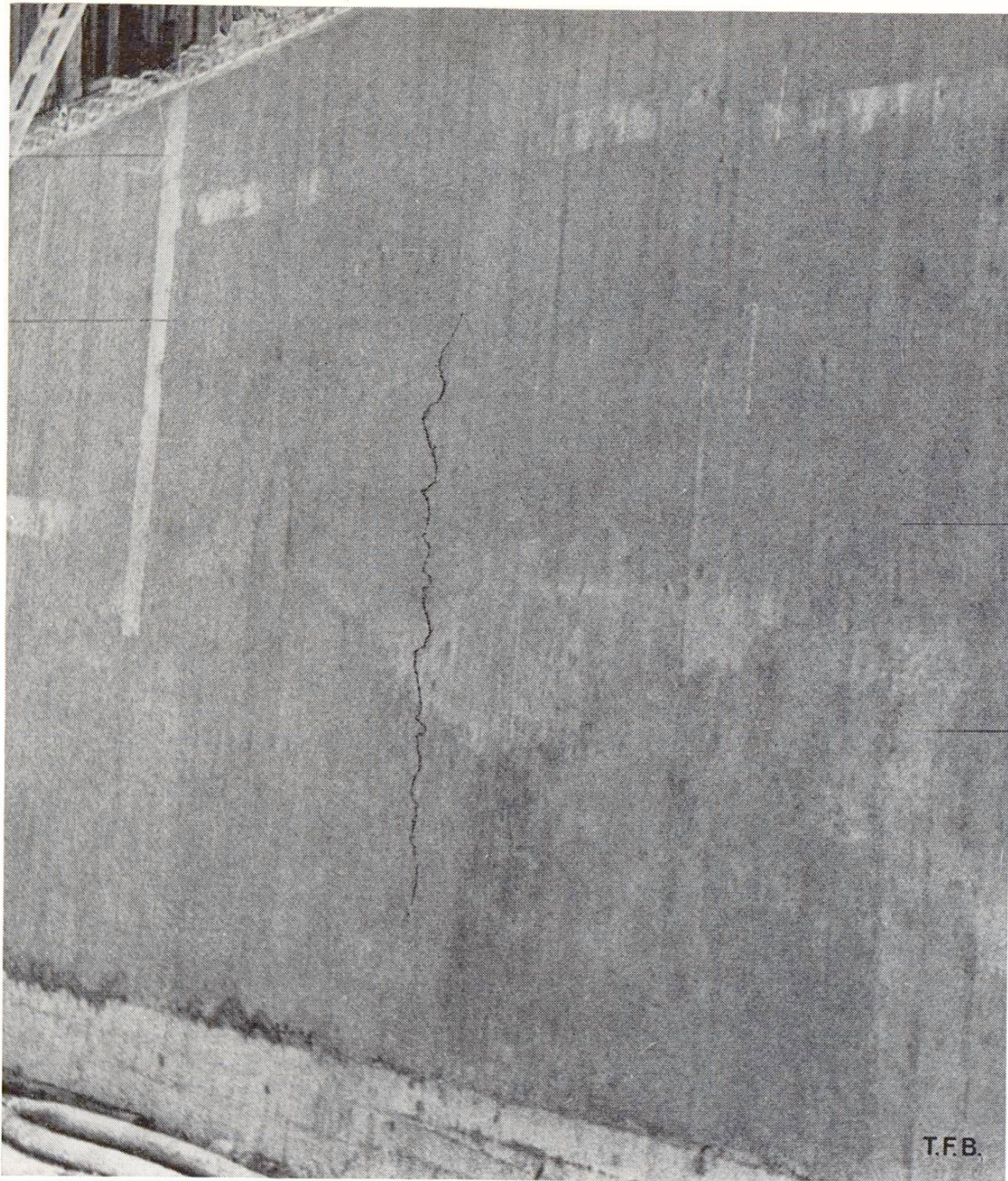
Fig. 1 Fissure profonde dans un mur de soutènement du type poids de 80 à 110 cm d'épaisseur (la fissure est légèrement soulignée).
