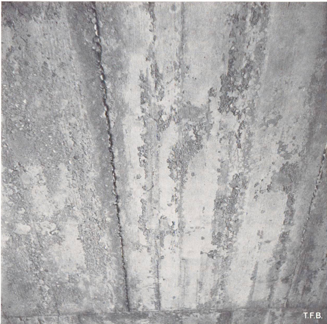
Fig. 7 Importants décolllements de la pellicule de ciment à la face inférieure d'une dalle; ils sont dus à un affaiblissement du mortier par excès d'eau (segrégation de l'eau à la surface du coffrage).
