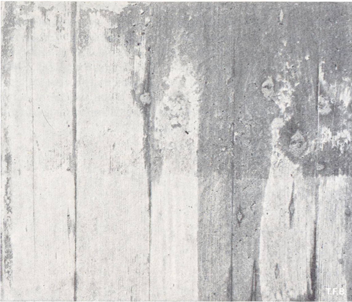
Fig. 4 Décollements de la pellicule de ciment dus à des voilements des planches de coffrage (3 e et 4 e planche à partir de la gauche; (représentation schématique à la fig. 2, au milieu). A la partie supérieure on remarque d'autres décollements dus à de légers glissements du béton le long du coffrage.
