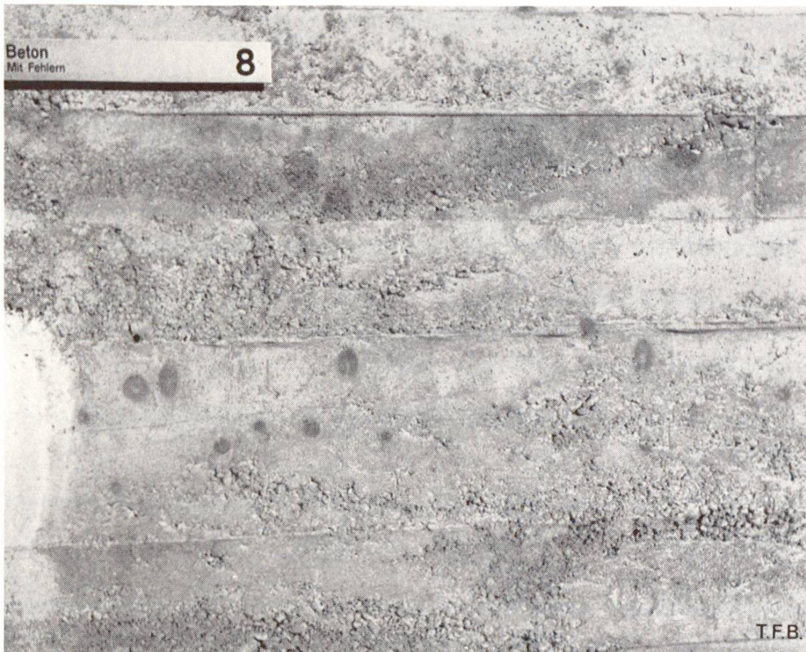
Fig. 3 et 4 Mur de soutènement ayant même fruit que celui des figures 1 et 2. Photos 1962 en haut et 1972 en bas. Béton de gros éléments, mal serré. L'aspect de ce béton a été aggravé par les intempéries. De fortes efflorescences se sont produites et la porosité de la surface a augmenté.
