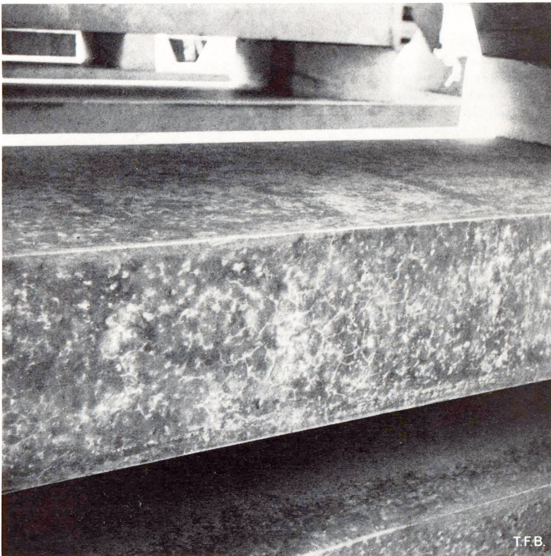
Fig. 6 Fines fissures en réseau apparaissant en blanc sur un béton à coffrage métallique. Elles sont probablement imputables à des différences de température dues à un dosage élevé en ciment. Le béton est resté foncé parce qu'il est très compact. Ce n'est qu'au voisinage des fissures que la chaux claire a été secrétée.
