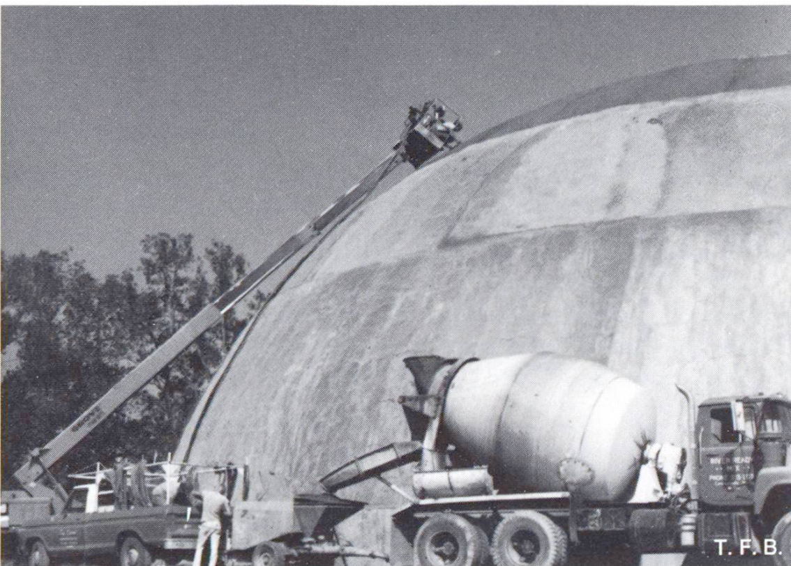
Fig. 9 Mise en place et talochage de la seconde couche de béton projeté. Une étanchéité sera appliquée ultérieurement.
