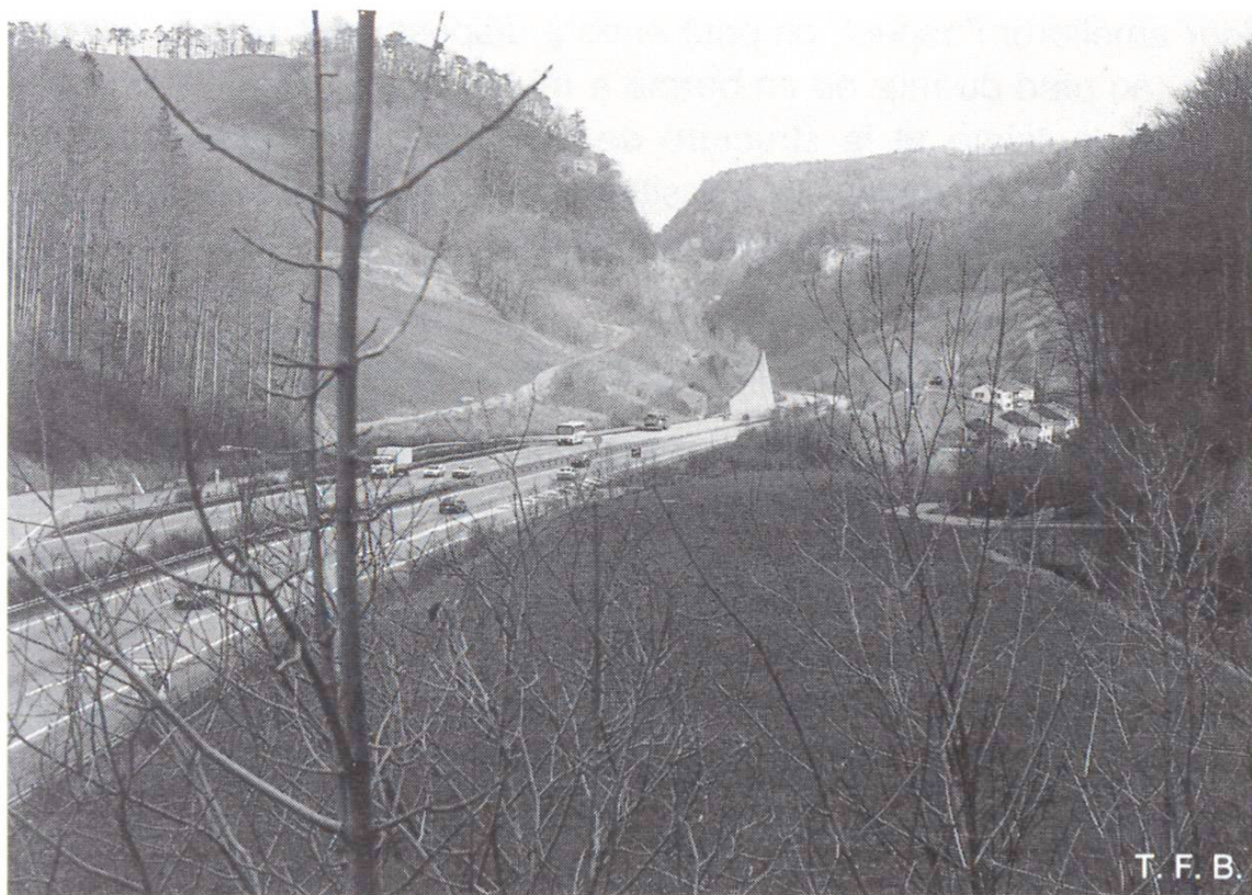
Fig. 5 Pour étudier l'effet optique, il faut considérer les points de vue des différents observateurs (au milieu de la photo, un mur de soutènement tel que le voit un automobiliste, N2 près d'Eptingen).
