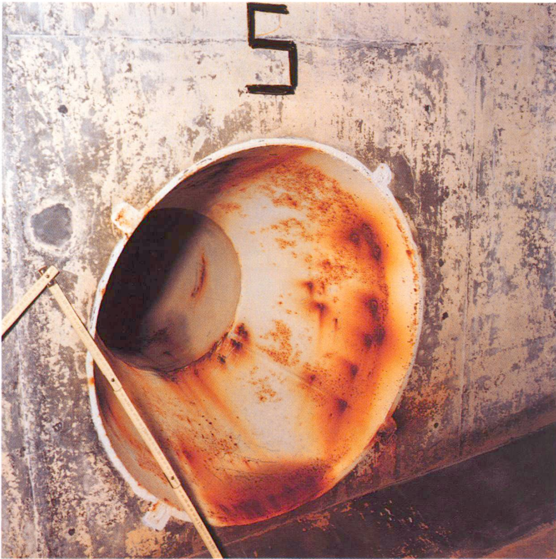
Fig. 3 Entonnoir de sortie d'un réservoir d'eau potable après 10 ans d'exploitation (St 37 zingué au feu avec enduit en matière synthétique).
