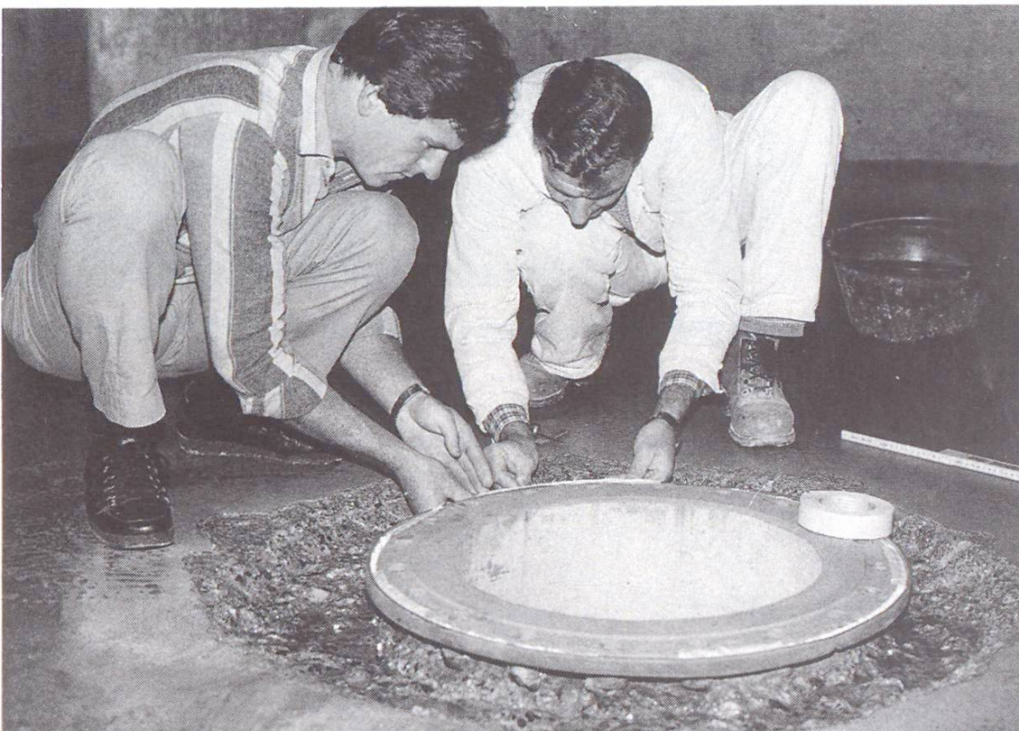
Fig. 6 Réparation d'une bride au moyen de ciment (passivation).
