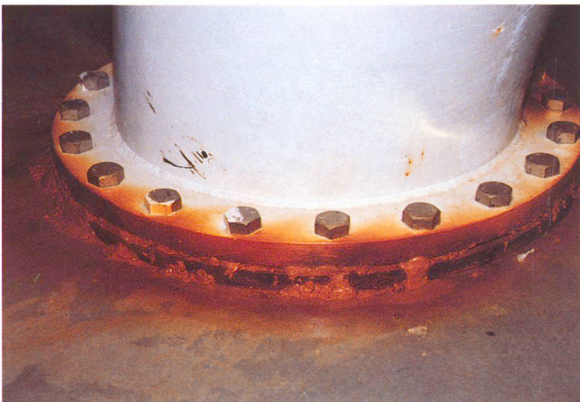
Fig. 4 Dégâts par corrosion dans un réservoir d'eau potable après 5 ans d'exploitation (même exécution que fig. 3).
