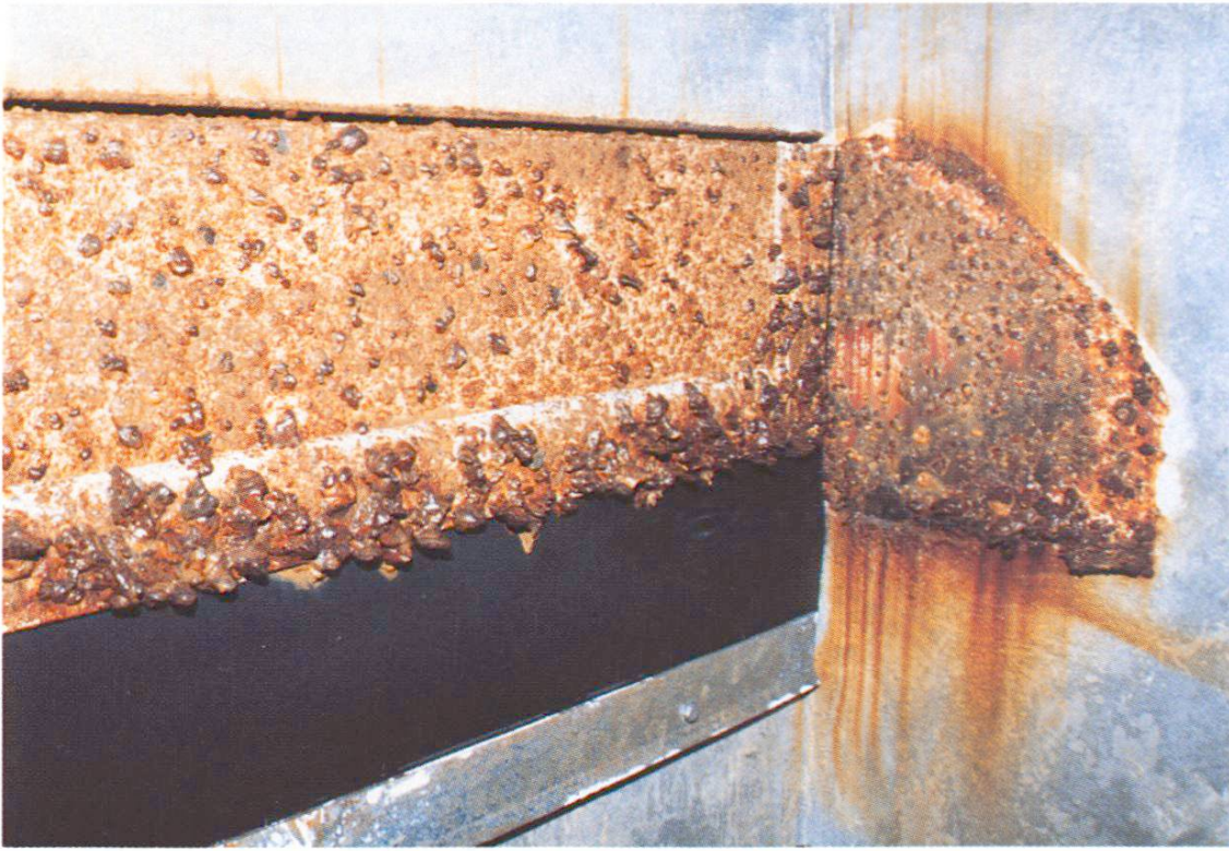
Fig. 5 Dégâts par corrosion au clapet de retenue d'un filtre à charbon actif après 5 ans d'exploitation. Corrosion aggravée à cause de l'alternance eau-air avec ozone (exécution idem fig. 3).
