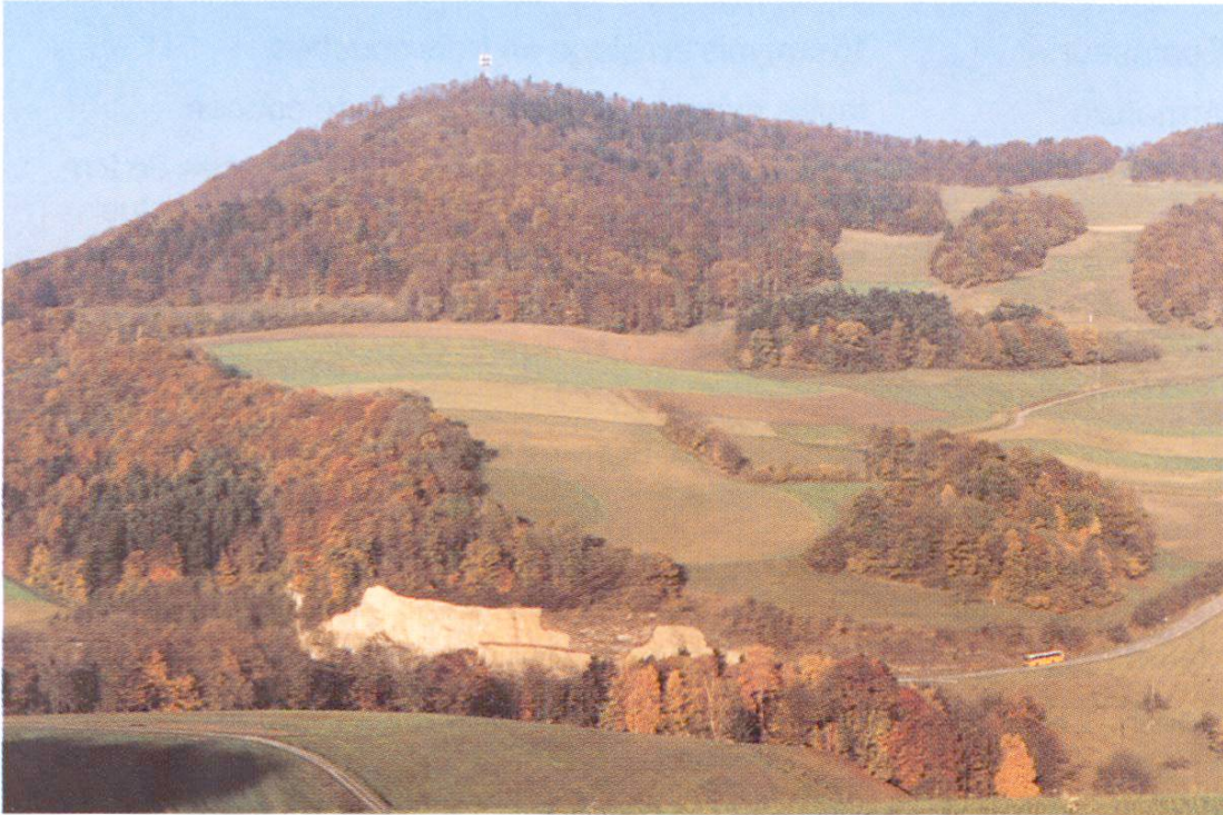
Fig. 12 Vue de la paroi rocheuse stabilisée. Elle se trouve en zone non habitée. Le déblai a été déterminé par le tracé de la route et, avant la stabilisation, consolidé par endroits seulement au moyen de treillis ancrés
