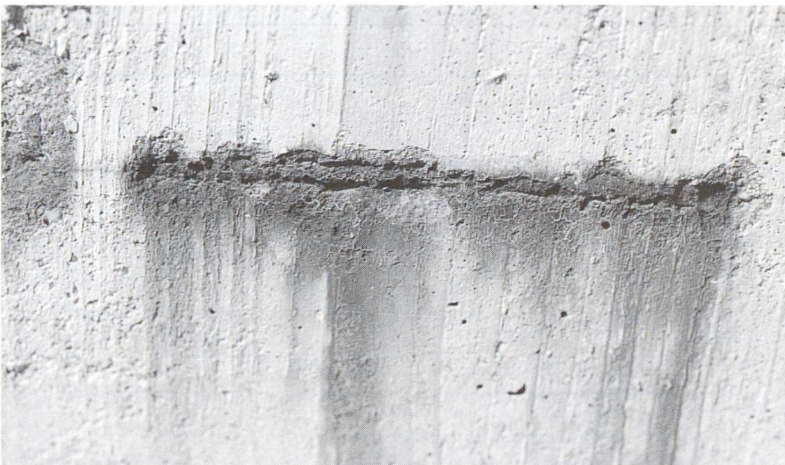
Eclatements résultant de la corrosion de l'armature.
