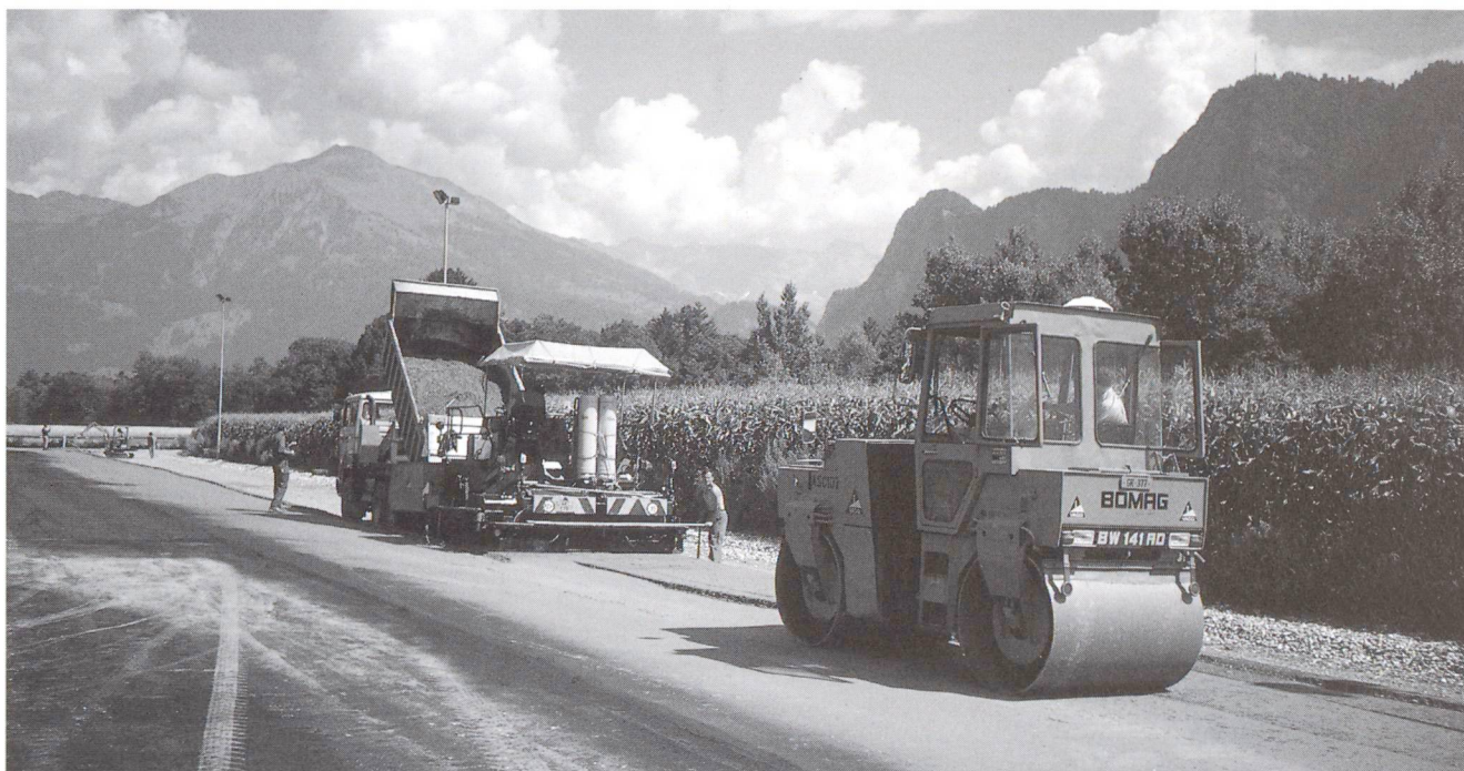
Mise en place à la finisseuse, suivie du compactage avec un rouleau vibrant.
