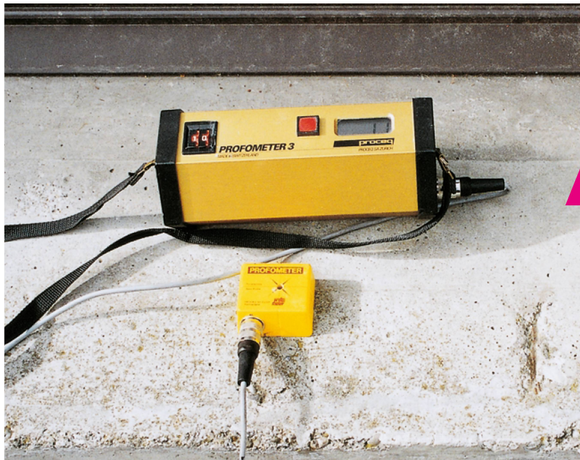
Mesure de l'enrobage d'un rebord de fenêtre dégradé par la corrosion.
