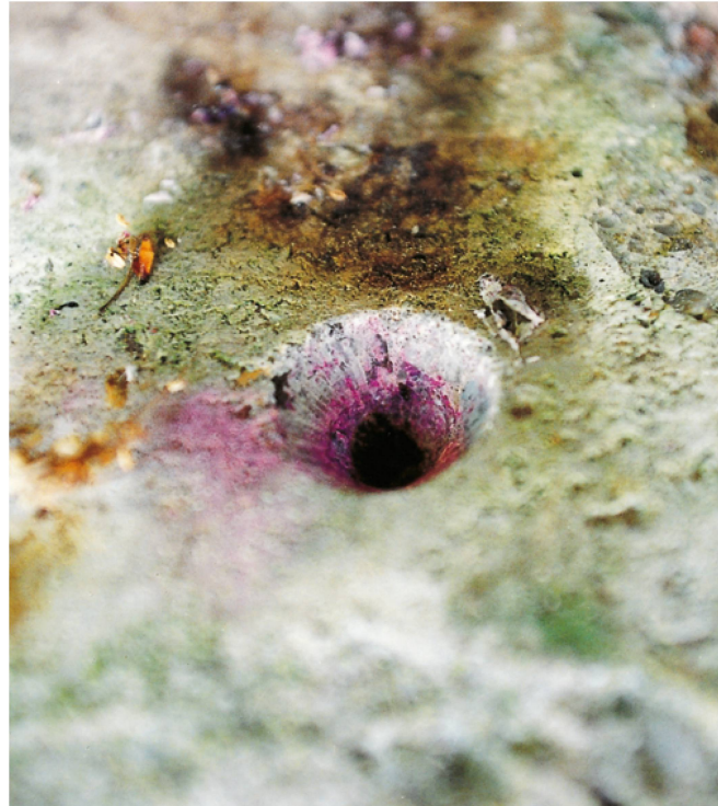
Détermination simple de la profondeur de carbonatation (test à la phénolphthaléine).
