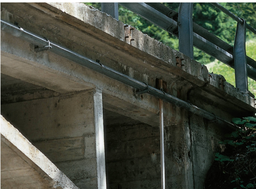
Partie de pont exigeant une réfection.
