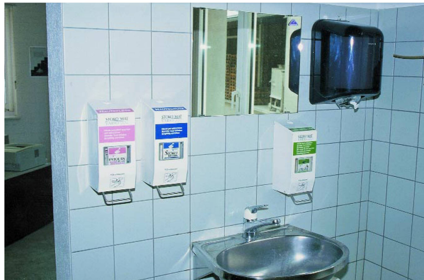
Fig. 10 Lavabo avec distributeurs de produits de protection, de nettoyage et de soins de la peau dans une entreprise de l'industrie suisse des liants.
