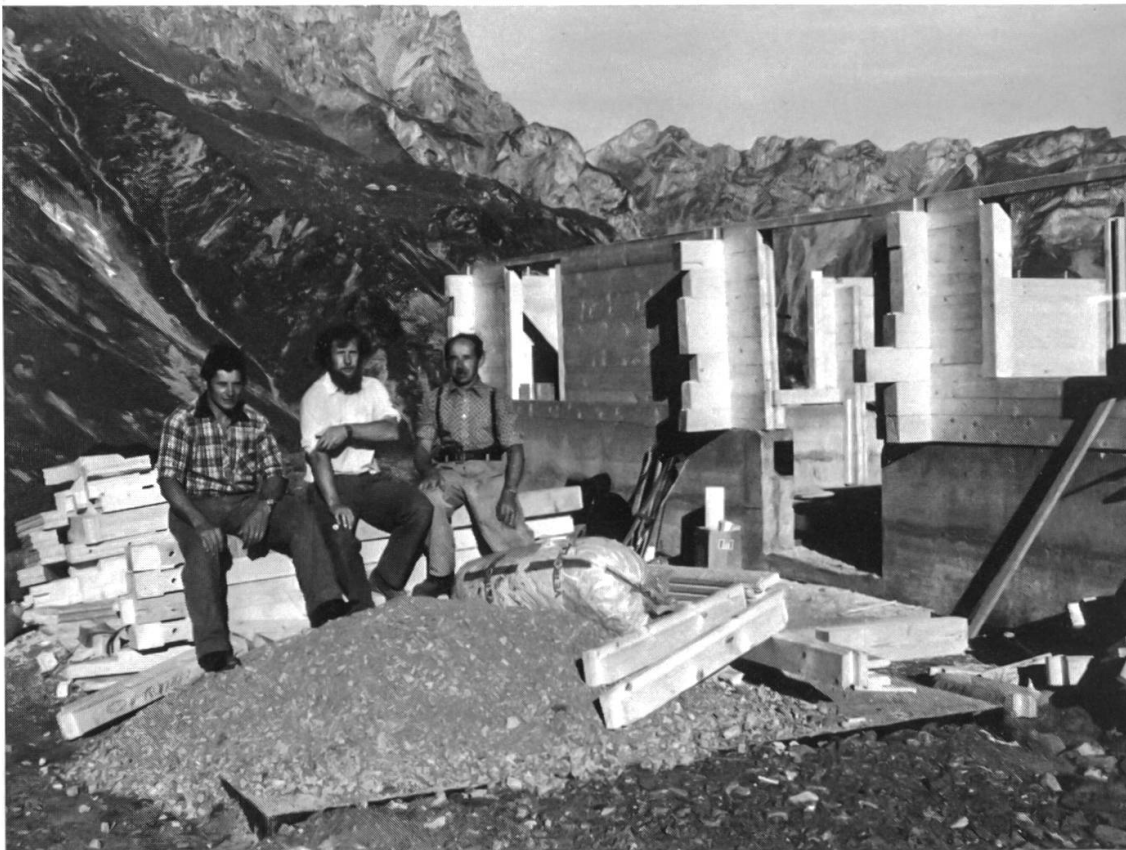
35 Kreuzhüttengaden auf Bannalp, erbaut 1963. In einem Teil des Oberbaus, im Bild an den Dachfenstern erkennbar, sind Massenlagerplätze eingerichtet.
