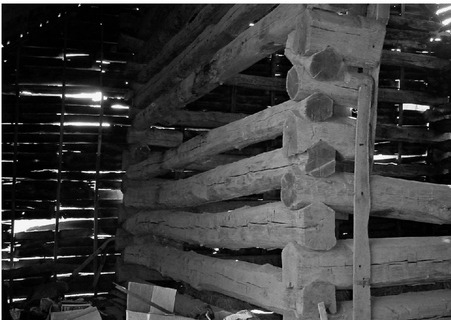
Blockbautechnik mit V-förmig zugeschnittener Verschränkung, eine eher skandinavische als alpine Zimmermannskunst. Folly Mills Creek, Arbor Hill (Virginia) (aus: http://bunnyvista.wordpress.com/2009/05/ ).
