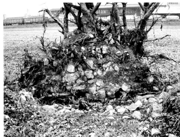
Fig. 5. Le Mur d'enceinte Vers la Gare, endommagé par la chute d'un arbre enraciné sur sa maçonnerie. Photo MRA.
