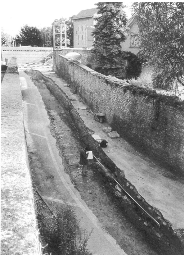
Fig. 24. Avenches/Route de la Grande Poya. Vue des travaux dans la partie amont de la rue.
