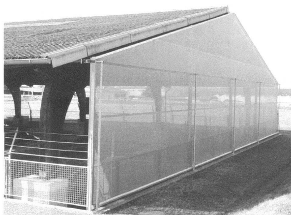
Fig. 1. Thermes de Perruet. Le filet de protection enroulable installé sur le côté oriental de l'abri (photo MRA).
