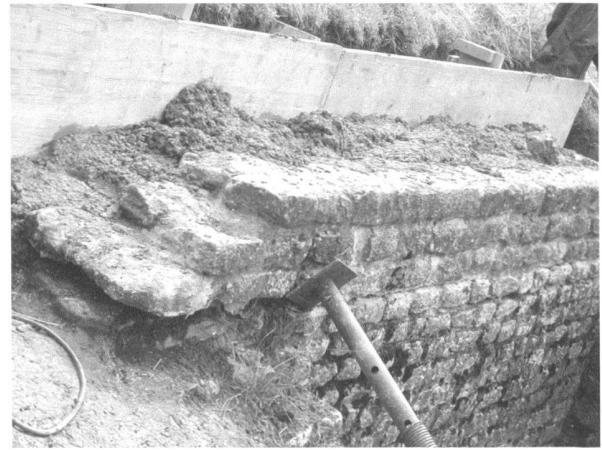
Fig. 4. Amphithéâtre. Le mur de fond de la cage d'escalier sud-est, naguère rehaussé, a dû être réparé et doublé d'un arrière mur de béton pour résister à la poussée des terres de la cavea engazonnée (photo MRA).
