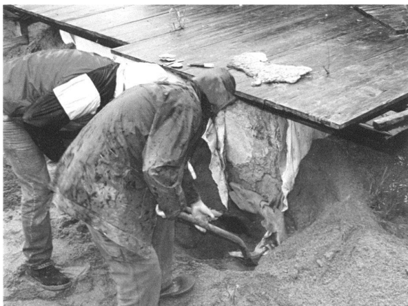
Fig. 26. Insula 19. Protection de vestiges à l'aide de géotextile et de sable. Photo MRA, laboratoire de conservation-restauration.
