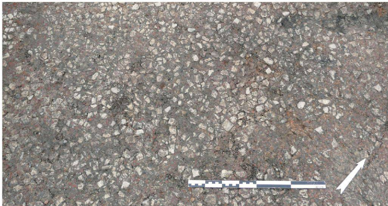
Fig. 36 (en haut) 2010.04. Route du Faubourg 6. Les restes de la dalle de seuil St 1 du mur M 1.
