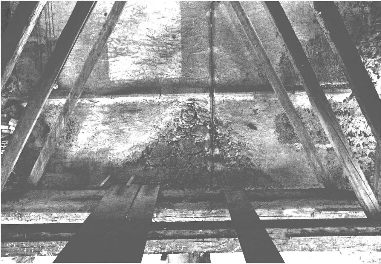
11 Giebelansatz der Kirche III am Turm, verputzte Turmwand und Anschluss des Verputzes an die Tuff-Eckquadern des Turmes.
