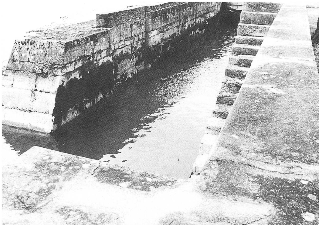
Abb. 14: Kammerschleuse beim Wehr in Windisch.
