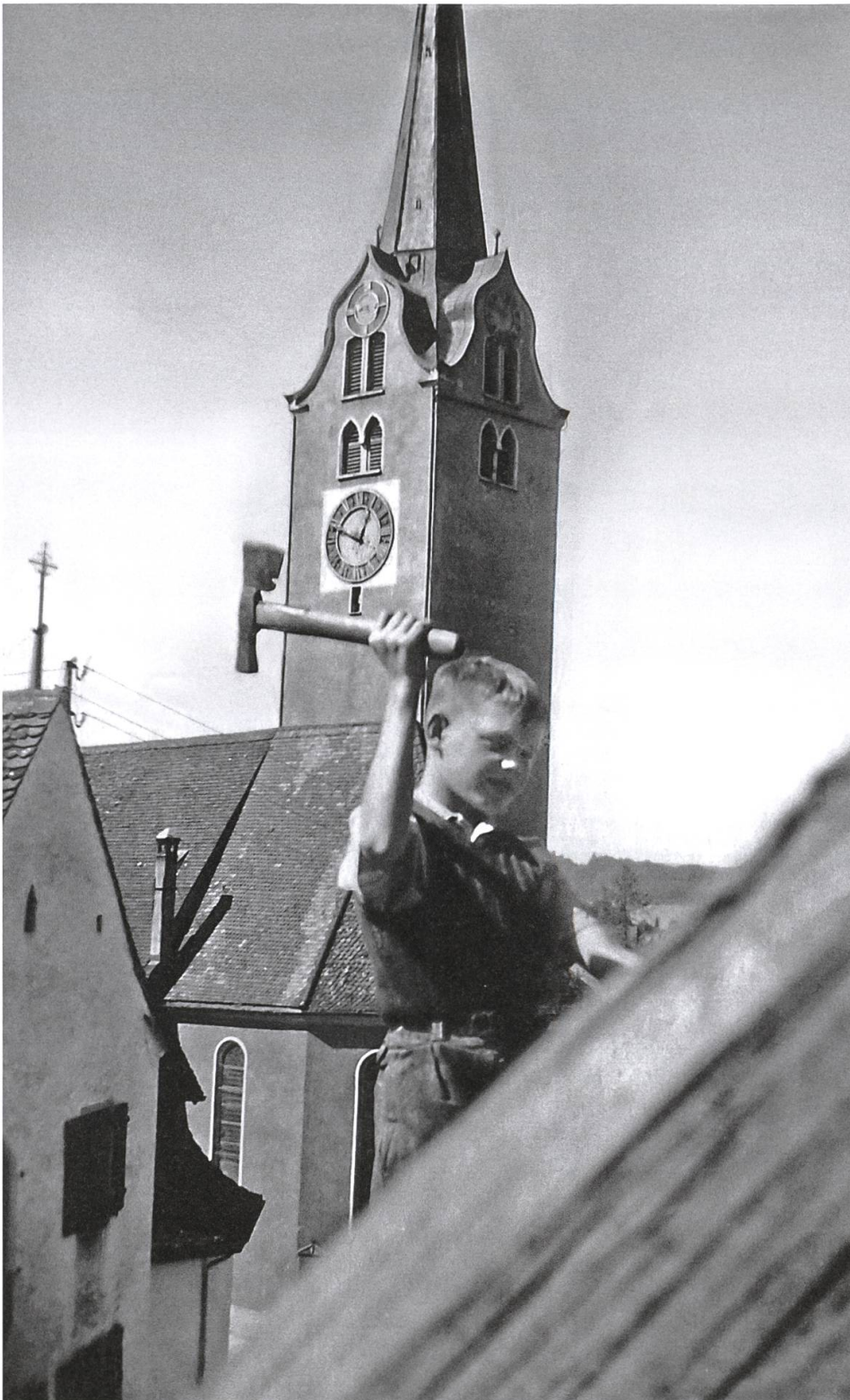
Dachrenovation am Henselerhaus (ca. 1953): Bruder Heinz schwingt die Axt vor dem Hintergrund der Pfarrkirche.
