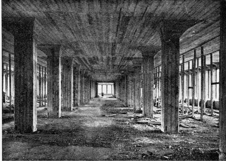
Fig. 16. — Bâtiment des Postes « Sihlpost », Zurich. Sous-sol. Postgebäude an der Sihl, Zürich Erdgeschoss. Sihl Postal Service Building, Zurich. Basement.
