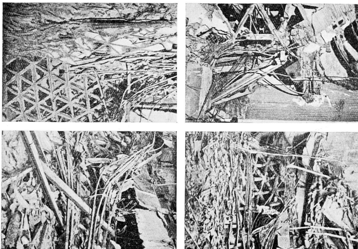
Fig. 11. Divers aspects de la désagrégation du béton.
