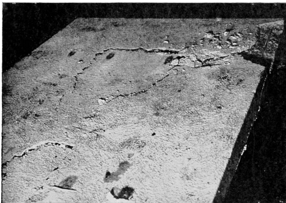
Fig. 14. Rupture en 2ème phase de l'essai à l'effort tranchant du panneau de 9 cm.
